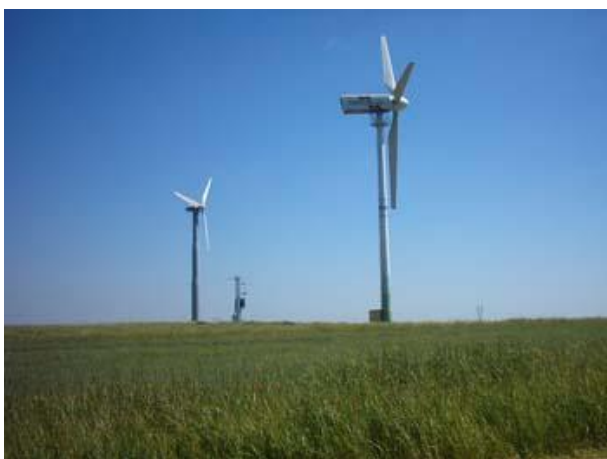
Rys. 99. Elektrownia wiatrowa w Boluminku źródło: www.agrinpol.pl
